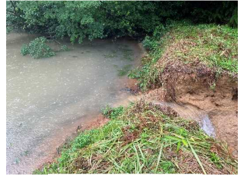
堤頂部の崩落した溜池
